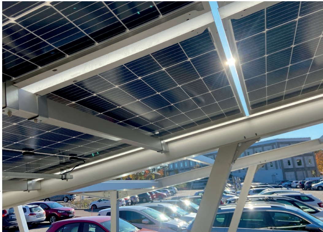
Solcellstaket på Oskarshamns sjukhusparkering täcker 76 parkeringsplatser.
